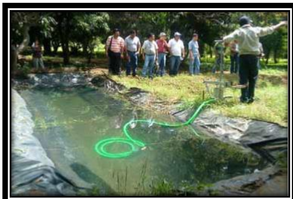
Figura 16. Reservorio de agua impermeabilizado con plástico
