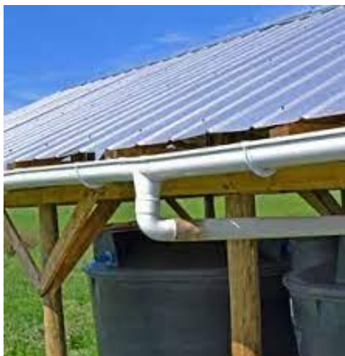
Figura 15. Ubicación de las canaletas para la conducción del agua
