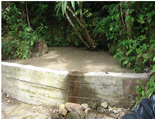
Figura 20. Condiciones del reservorio de agua después de las primeras lluvias
