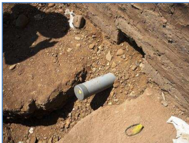
Tubería salida de mezcla fijada
