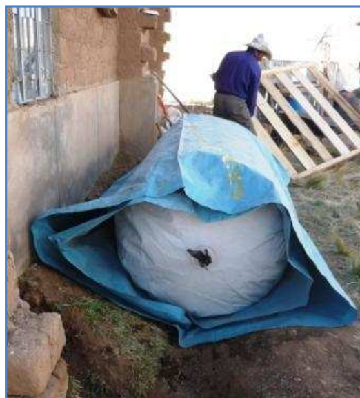
Gasómetro ubicado en la zanja
