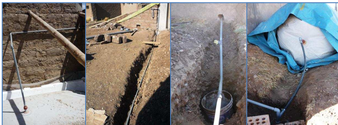
Tubería de conducción del biogás instalada
