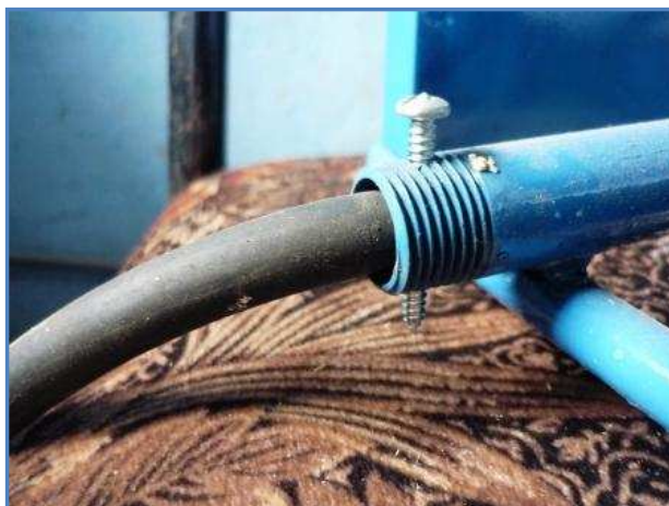
Tubería de caucho conectada a la tubería de fierro
