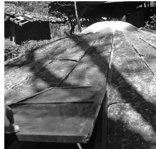
Ventana de inspección antes de la unión de las tejas del techo
