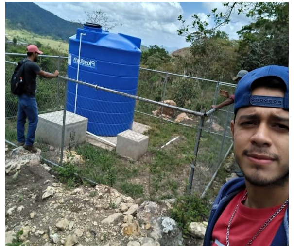
5 Sistema mini acueducto por gravedad implementado por el organismo El Porvenir para brindar el servicio de agua potable a los beneficiarios
