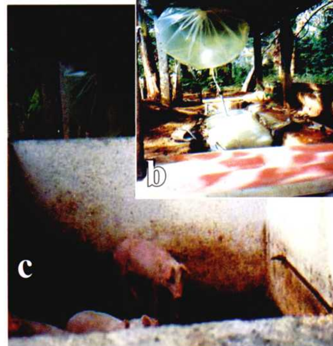
Figura 6. Reservorio de gas. a) sin instalar y vacío; b y c) instalado y lleno de biogás.
