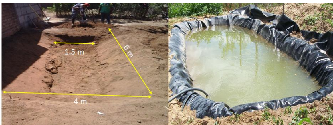
Figura 6. Establecimiento del sistema de captación de agua en la comunidad de Santa Julia, El Crucero, Managua.
