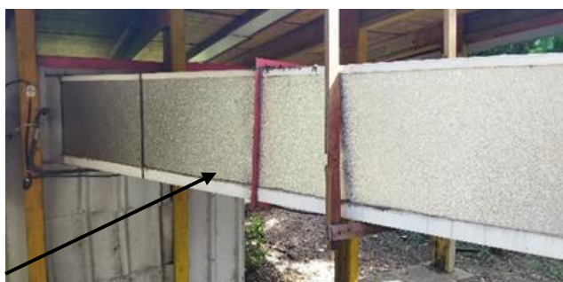
Figura 7. Ductos de conducción de aire caliente
