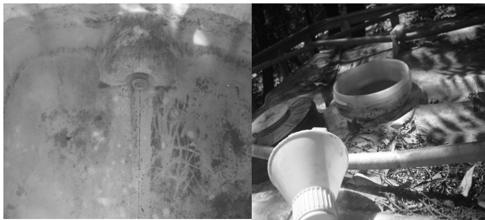
Figura 13. Suciedad en parte interna y externa tanques de agua.
