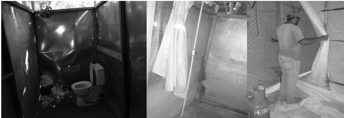
Figura 11. Módulos sanitarios sucios y baño al personal no exigido
