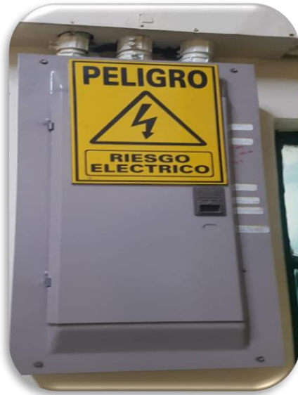
Figura 33. Pictograma de peligro eléctrico, ubicado en panel eléctrico
