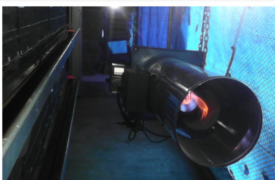
Foto 3. Calentadora a gas Master Jet Tomada por Ubeda (2017)
