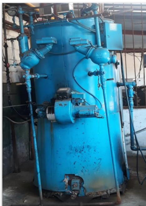
Anexo 8. Caldera para calentar el agua que es utilizada en los esterilizadores
