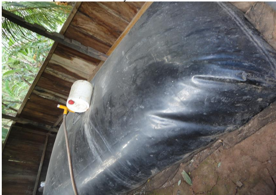
Foto 2.- Biodigestor tipo bolsa, Finca “Las palmas” Muelle de los Bueyes. Propietario: Damián Taleno.
