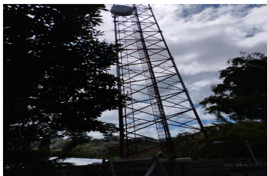
Figura 15: Torre telefónica Fuente: Propia
