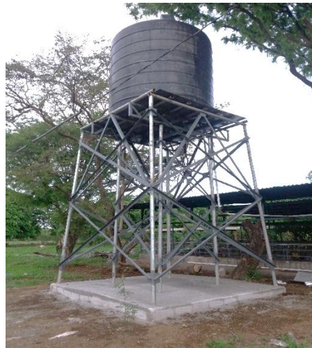
Anexo 7. Almacén de agua
