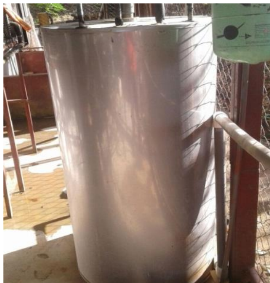
Fotografía 2. Acumulador de agua caliente.
