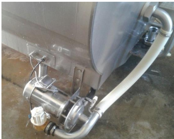
Fotografía 1. Sistema de lavado y desinfección de tanque.
