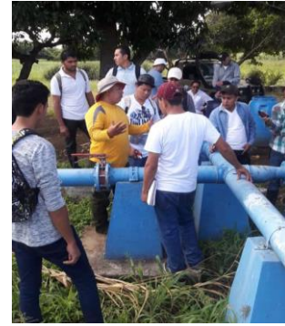
Figura 15. Sistema de bombeo
