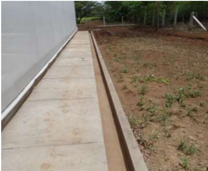
Figura 1. Canaleta de agua para prevenir la entrada de insectos al interior de la casa malla.
